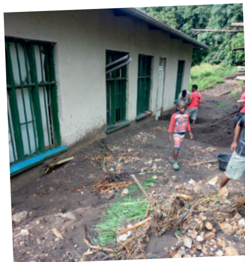
Erosionen im Kinderdorf Patmos
